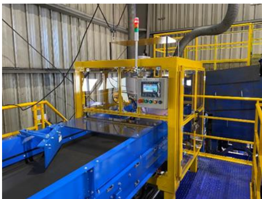
ロボット選別システム全景
