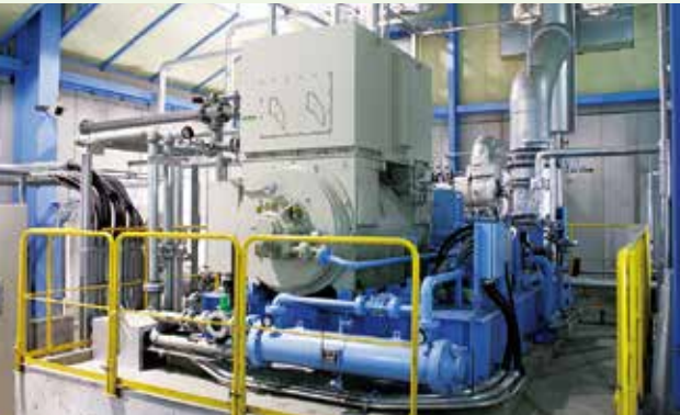
蒸気タービン発電機
