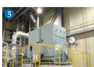
タービン発電機
