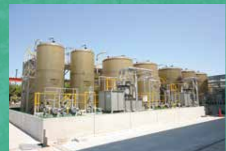
廃液受け入れ設備
