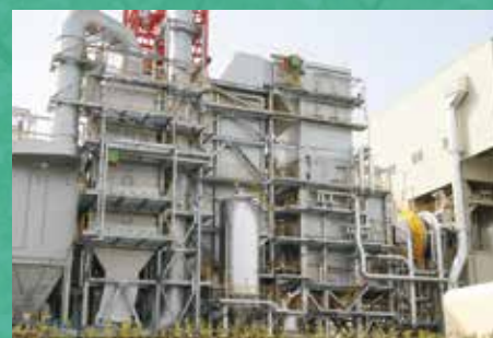
ボイラ+二次燃焼室
