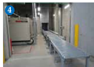
直接投入装置
