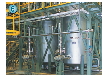
フレーク洗浄装置
