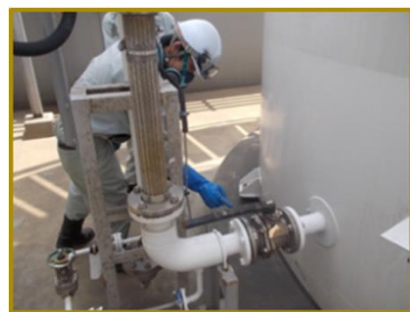
漏洩箇所の確認
