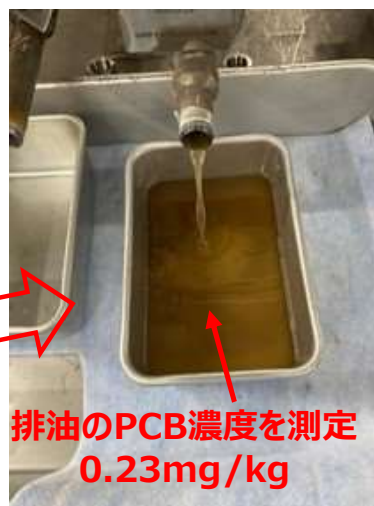
油噴燃ポンプA入口ドレン
