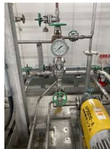
油噴燃ポンプA出口圧力計
