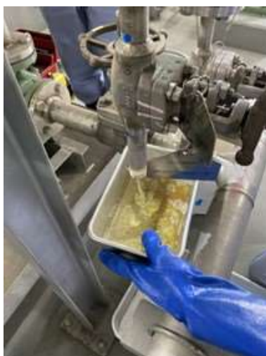
油移送ポンプK2出口ドレン
