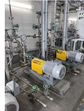
油噴燃ポンプ
