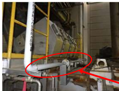
給じん装置散水設備
