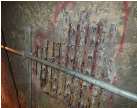
耐火材脱落状況
