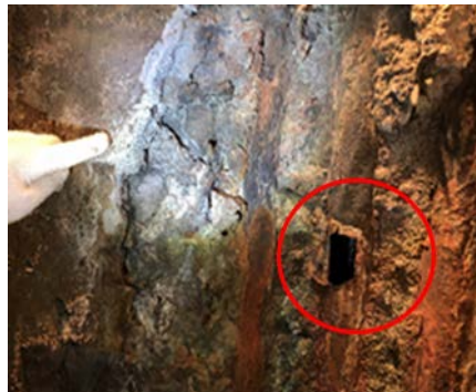
ボイラー水壁管破孔箇所
