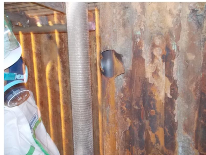
廃熱ボイラー破口部
