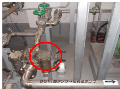
漏洩発生箇所(スルー上部)
