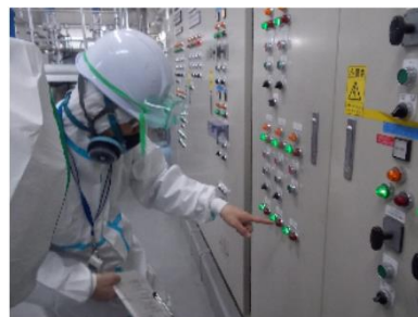
油ポンプ停止確認
